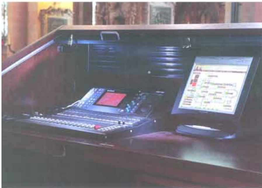
Regietisch nahe des Altars mit Yamaha L59 und Crestron Touchpanel. Einzelne Lautsprecherpositionen sind per Fingerdruck ein- oder auszuschalten – für Übersicht sorgt ein Grundriss des Doms, auf dem die einzelnen Positionen als Punkte markiert sind – je nach Aktivität grün oder rot.
