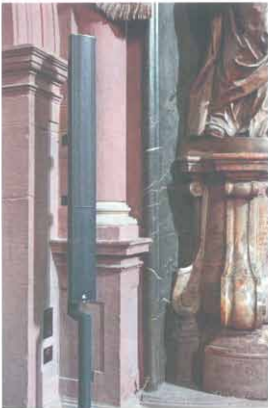
Jede Zeile musste einzeln passend zum jeweiligen Steinpfeiler austariert werden. Die innen hohlen Lautsprecherstelen dienen gleichzeitig auch als Kabelzuführung.
