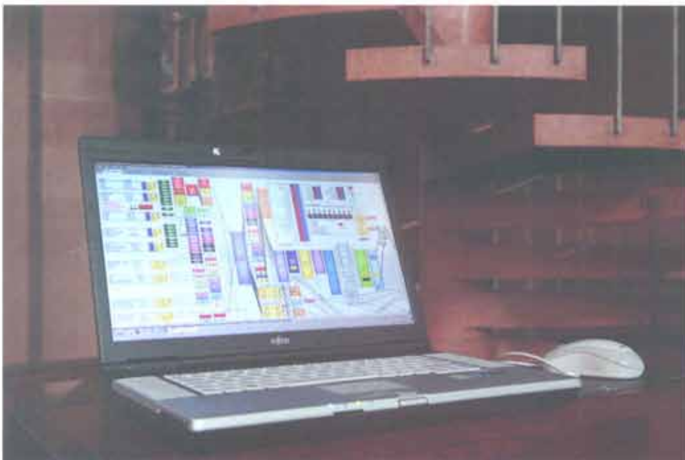
Für die Programmierung nutzte Tribensky die zur QSC-Systemplattform gehörende „Q-System Designer“-Software, welche die Arbeit durch ein ansprechend gestaltetes GUI erleichtert.
